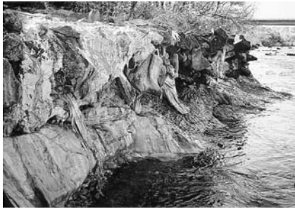
荒川に流れ込んでいる汚水
